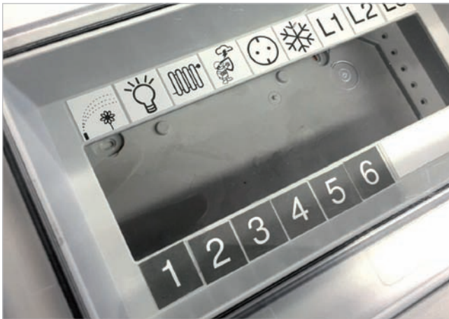
Obr. 5 Prehľadné označenie prístrojov rozvodnice SDB
